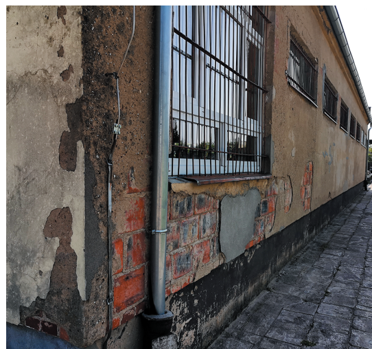
Fragment zniszczonej elewacji
